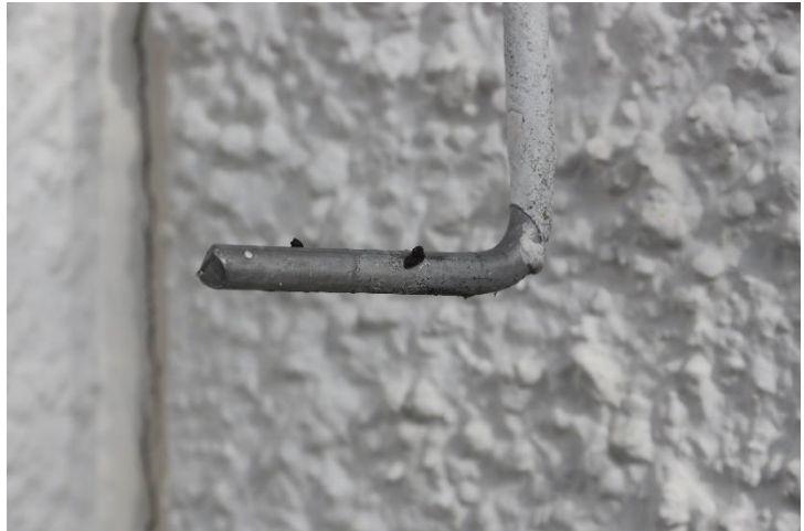
Einzelne Kotkrümel an ei- nem Metallhaken unter dem Quartier am Anbau des Hauptgebäudes.
